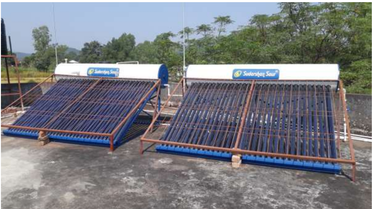
Auf dem Dach des großen Mädchenboardings in Junwani wurden, wie auf allen großen Boardings, zwei Anlagen installiert.
