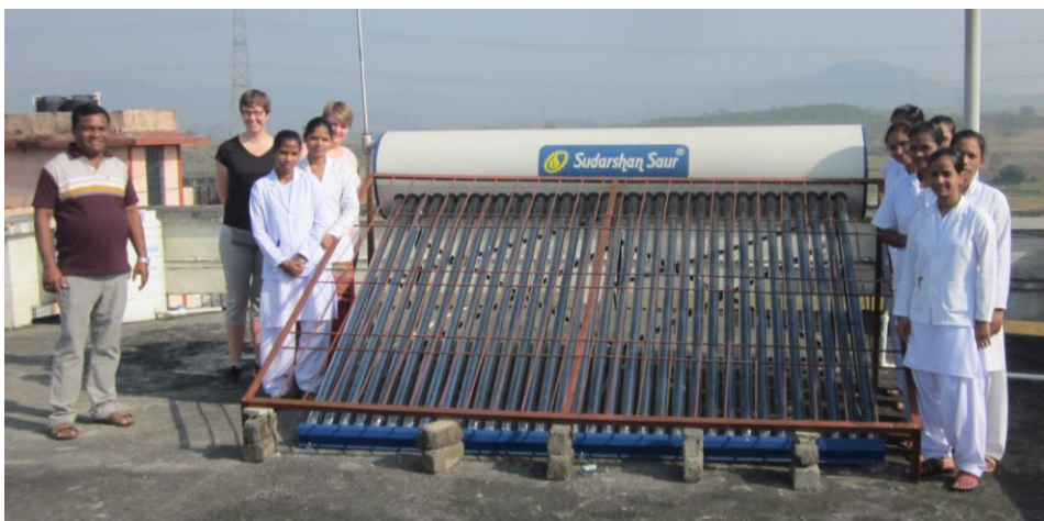
Solar-Warmwasser-Anlagen: zu sehen auf jedem Dach eines Boardings
