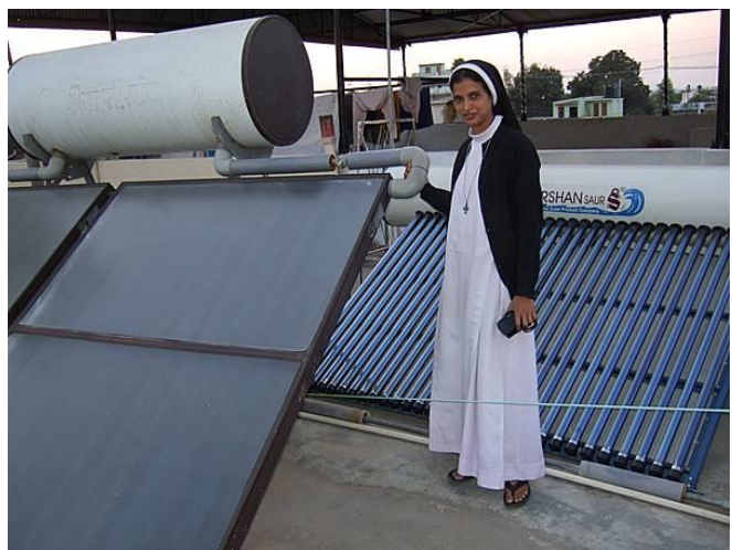
Solar-Warmwasser-Anlage auf dem Dach des Hauses für sterbenskranke Patienten in Shadol
